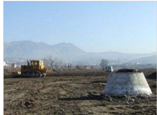
TRABAJOS. Maquinaria pesada de la empresa adjudicataria de las obras explanaba ayer los terrenos por donde discurrirá la futura autovía que configurará el distribuidor norte. / SERGIO GONZÁLEZ NAVEROS
